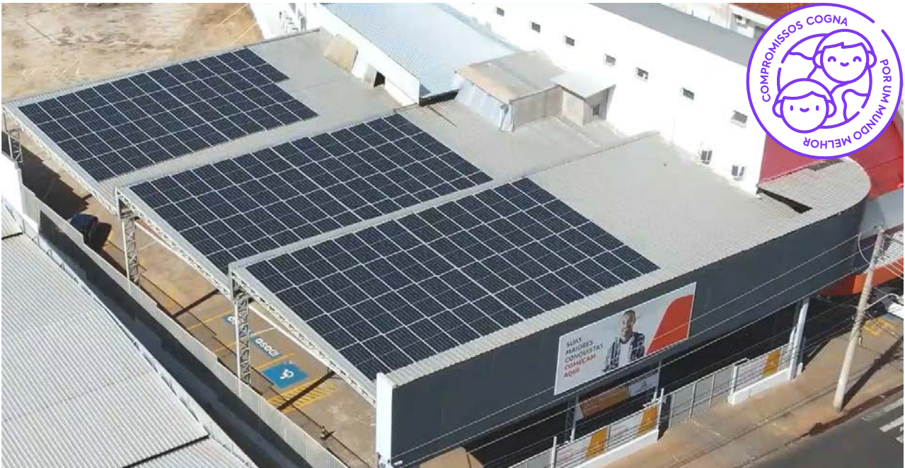
Painéis fotovoltaicos da unidade Anhanguera de Jaú (SP)
